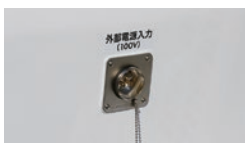
(20)100V電源引込装置(室外)*2
