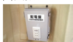
(20)100V電源引込装置(室内)*2
