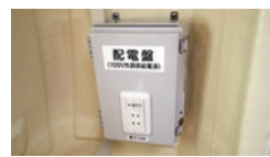
(20)100V電源引込装置(室内)*2
